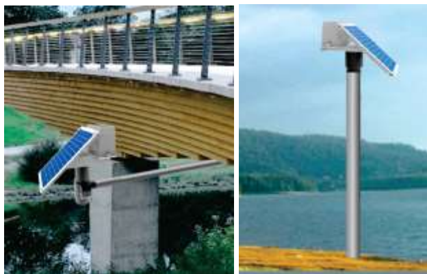
Фиг. 2 Монтирани станции за автоматично наблюдение нивото на реките
